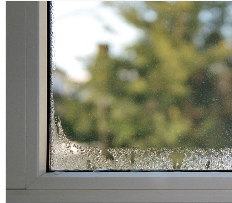
Bild 6: Kondensation an eine Isolierglasfensterscheibe auf der Raumseite
